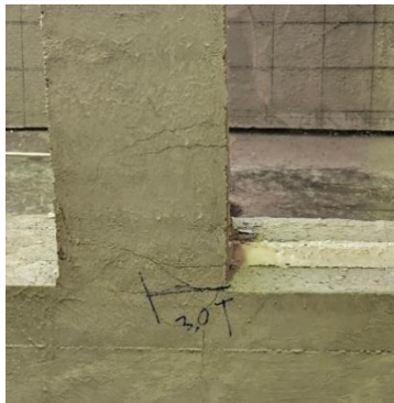
รูปที่ 14 ตำแหน่งเริ่มเกิดรอยร้าวในโครงข้อแข็งที่ไม่มีวัสดุก่ออิฐมวลเบา
