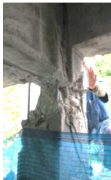
รูปที่ 1 เสาคอนกรีตเสริมเหล็กปกติและที่เกิดความเสียหาย [4]
