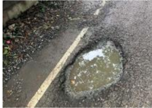
รูปที่ 6 ลักษณะความเสียหายชนิดหลุมบ่อ (Potholes) ถนนราชดำริ
