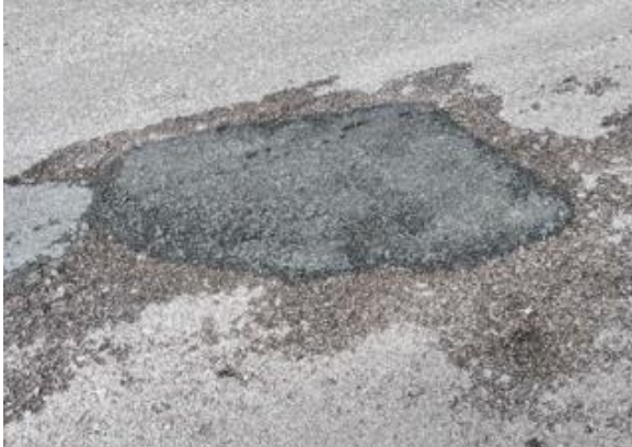
รูปที่ 4 ลักษณะความเสียหายชนิดรอยปะซ่อม (Patching) ถนนเทพารักษ์
