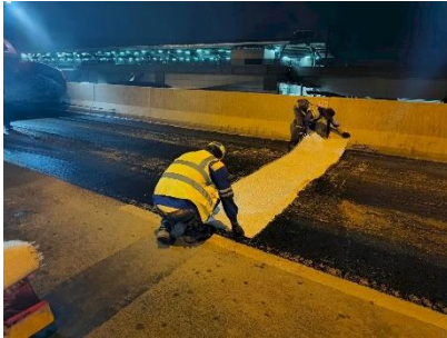
รูปที่ 9 วัสดุฝุ่นใยสังเคราะห์ในทางยกระดับคอนกรีต
