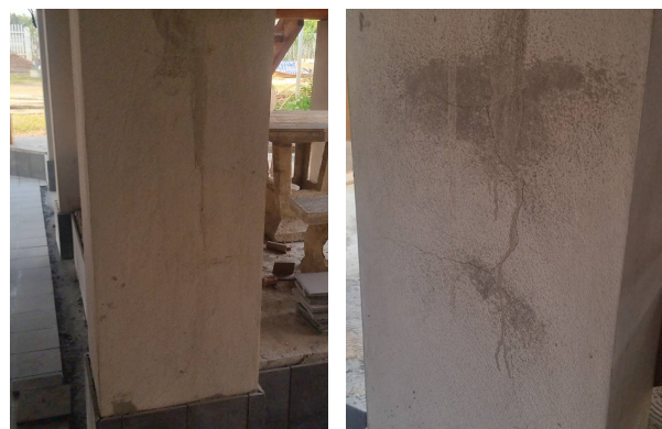
รูปที่ 17 รอยแตกที่ปูนฉาบเสาหลังเกิดแผ่นดินไหว 28 มีนาคม 2568
