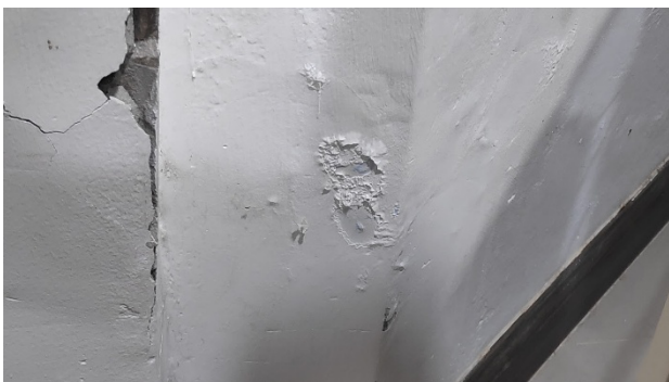
รูปที่ 1 ตัวอย่างปัญหาความชื้นในบ้านพักอาศัย
