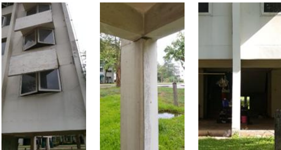
ก. รอยแตกร้าวบนผนัง ข. รอยปริแตกกับคาน ค. เสาเอนไปจากแนวตั้ง รูปที่ 3 ร่องรอยความเสียหายของอาคาร
