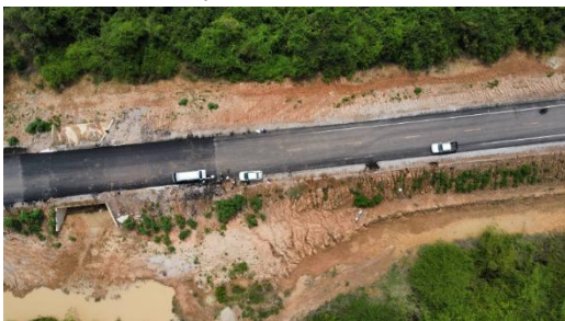
รูปที่ 4 สภาพการกัดเซาะทั้งสองข้างของถนน นพ 3017 สร้างพาดผ่านป่าบึงปทุมกลุ่มน้ำศรีสงคราม
