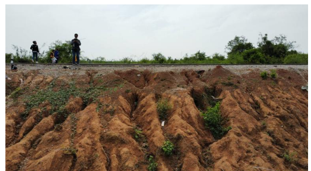
รูปที่ 9 การกัดเซาะแบบ Gully ด้านข้างคันทางถนน นพ.3017 หลังจากเปิดใช้งานได้เพียง 1 ปี
