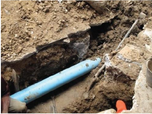
รูปที่ 1 การเกิดช่องว่างใต้ท่อ [5]
