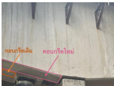
รูปที่ 2 บริเวณรอยต่อระหว่างคอนกรีตเดิมและคอนกรีตใหม่
