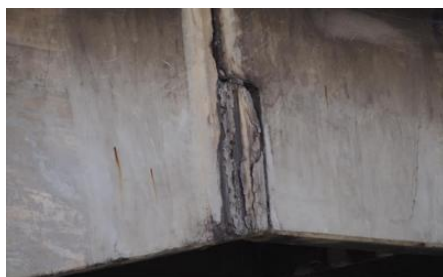
รูปที่ 1 ความเสียหายบริเวณบาคา
