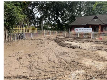
รูปที่ 1 สภาพพื้นที่ที่เกิดการทับถมของดินตะกอนบริเวณอาคารเทิดพระเกียรติ 90 ปี สมเด็จพระศรีนครินทร์ อำเภอเมืองเชียงราย
