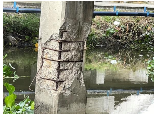
รูปที่ 2 การหลุดร่อนและแตกออกของคอนกรีต
