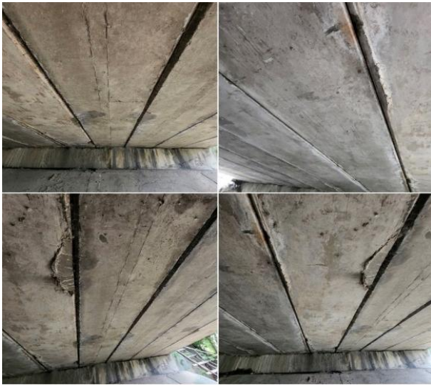
รูปที่ 3 ความเสียหายเนื่องจากการหลุดร่อนของผิวคอนกรีต
