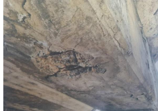
รูปที่ 1 การเกิดสนิมในเหล็กเสริมคอนกรีต
