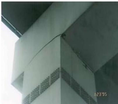
รูปที่ 1 รอยแตกที่รอยเชื่อมระหว่างเสาและคานของเสาสะพานเหล็กในระหว่างแผ่นดินไหวที่เมืองโกเบ เมื่อปี 1995
