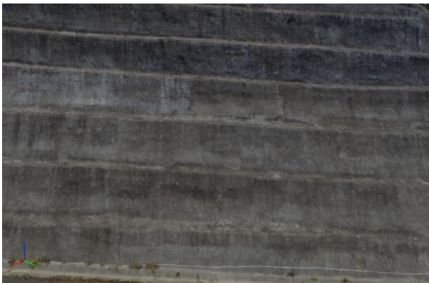
รูปที่ 6 ครบน้ำที่เกิดขึ้นบนพื้นผิวลาดดินไหล่ทาง
