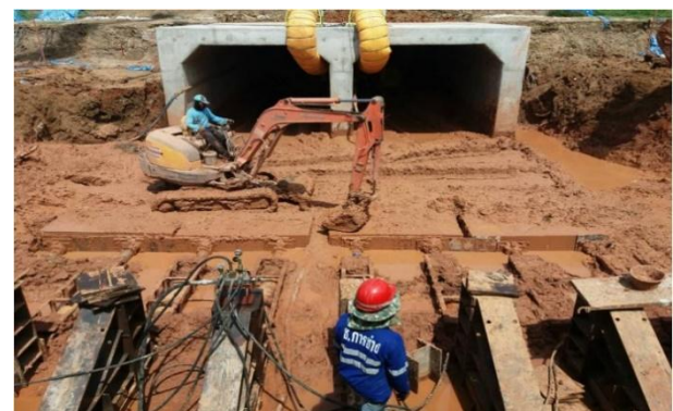
รูปที่ 24 Thrust Bed with Concrete Spacer
