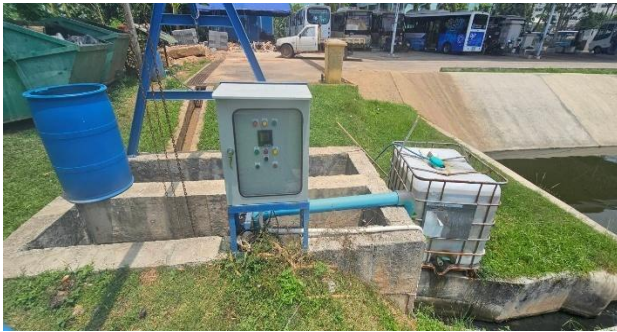
รูปที่ 4 บ่อรวมน้ำเสีย (Sum / Screening )
