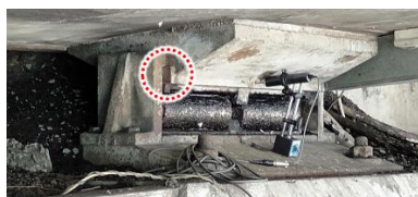
รูปที่ 9 ส่วนบนของ Roller bearing เคลื่อนตัวออกจากตอม่อบดบิรม
