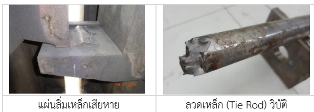
รูปที่ 5 ความเสียหายบริเวณกึ่งกลางสะพาน
