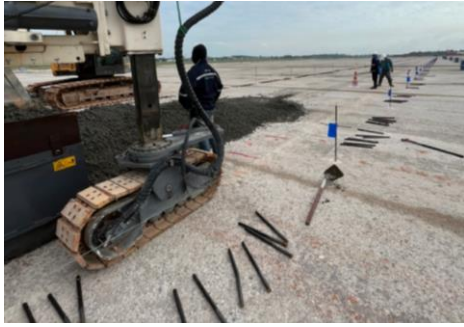
รูปที่ 19 การเทคอนกรีตก่อนเครื่องปูคอนกรีตเคลื่อนตัวมาถึง
