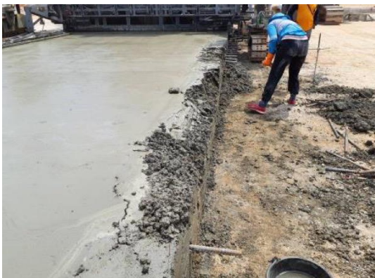
รูปที่ 35 เนื้อคอนกรีตออกทรายทำให้ไหลร่วง
