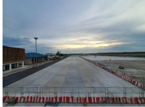
รูปที่ 25 ลานจอดเครื่องบินหลังการเทคอนกรีตและตัดรอยตัดแล้วเสร็จ
