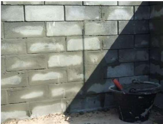
รูปที่ 13 การก่อผนังด้วยคอนกรีตบล็อกผสมแก๊สละลอะพริ้ว
