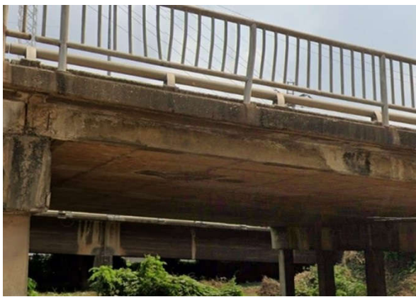
รูปที่ 4 การหลุดร่อนเฉพาะจุดของคอนกรีต
