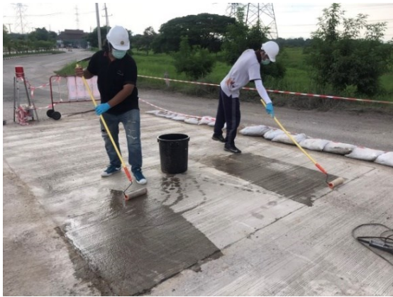
รูปที่ 5 ภายหลังจากเท แต่งผิวหน้า และกรีตลายถนน เคลือบผิวหน้าถนนคอนกรีต AFA ด้วยสารละลาย \text{Na}_2\text{SiO}_3
