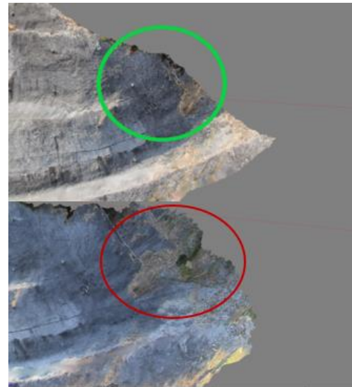
รูปที่ 14 การเกิดลักษณะดินถล่มบริเวณลาดดินคอนกรีตพ่น
