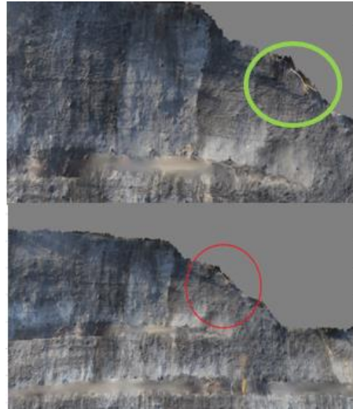
รูปที่ 13 การเกิดลักษณะดินตัดบริเวณลาดดินคอนกรีตพ่น
