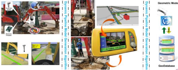
รูปที่ 18 แบบจำลอง AR ขั้นตอนขุดเปิดหน้าดินเพื่อเตรียมวางบ่อพักสายไฟ
