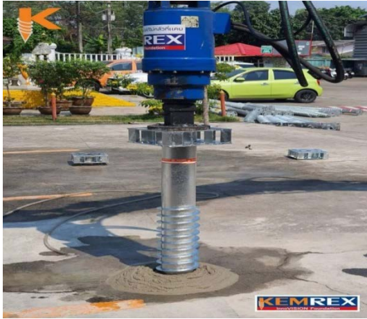
รูปที่ 4 การติดตั้งเสาเข็มเหล็กของบริษัท เข็มเหล็ก จำกัด
