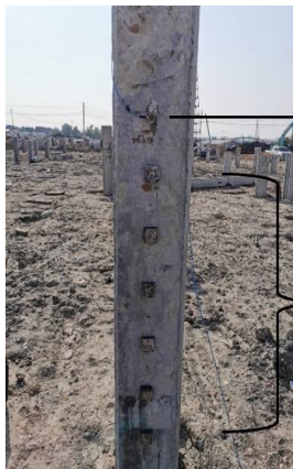
รูปที่ 4 ตัวอย่างลักษณะของสถานที่ทำการทดสอบและตัวอย่างการติดตั้งอุปกรณ์
