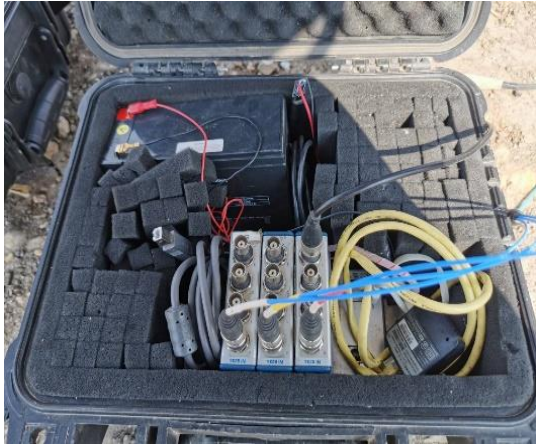
รูปที่ 3 โมดูลแปลงสัญญาณ และ Data logger
