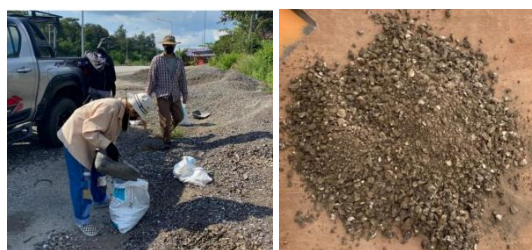
รูปที่ 1 วัสดุมวลรวม RAP จากผิวทางเดิมของหลวงหมายเลข 12 บริเวณตอนควคุ่มที่ 0201 แม่ละเมา - ตาก ระหว่าง กม.74+000 ถึง กม.76+607
