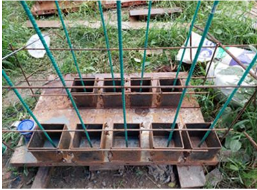
รูปที่ 1 แบบหล่อคอนกรีตตัวอย่างคอนกรีต มีขนาดทรงลูกบาศก์ 150 มม.
