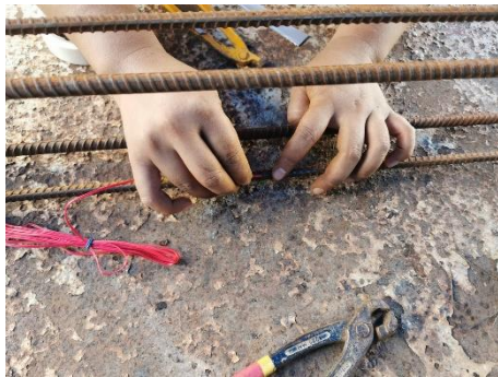
รูปที่ 7 การติดตั้งเกจวัดความเครียด (Strain gauge) ที่ผิวเหล็ก
