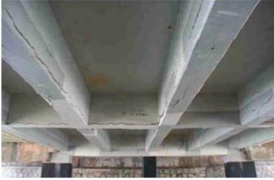
รูปที่ 4 ตัวอย่างลักษณะของการเกิดรอยแตกร้าวโครงสร้างทางยกระดับ
