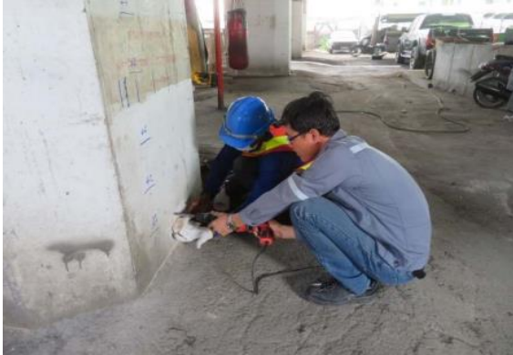
รูปที่ 7 การตรวจวัดหาระยะการเกิดคาร์บอนเนชั่นในโครงสร้างคอนกรีตเสริมเหล็ก
