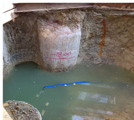
รูปที่ 2 การขุดเพื่อก่อสร้างชั้นใต้ดินที่ความลึก 18.50 เมตร เมื่อปี ค.ศ. 2017 มีน้ำใต้ดินไหลเข้ามาในบ่อขุด
