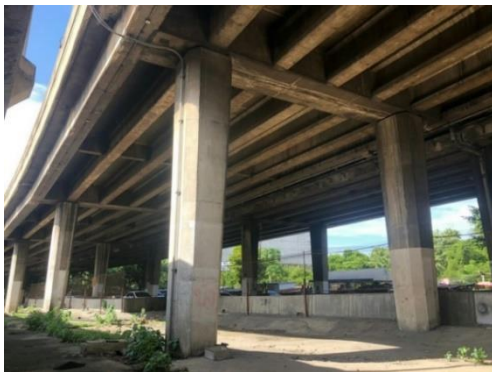
รูปที่ 5 รอยต่อของโครงสร้างสะพาน รูปแบบ Full Joint
