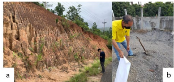
รูปที่ 5 ตัวอย่างลาดดินที่มีการกัดเซาะสูงในพื้นที่เขตทางหลวง ทล.1192 จังหวัดเชียงใหม่ (a) และภาคมิลลิ่งยางมะตอยจากงานทาง (b)
