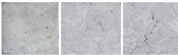
ก) 300°C ข) 500°C ค) 700°C รูปที่ 4 การแตกร้าวที่ผิวคอนกรีตเมื่อได้รับความร้อนสูง
