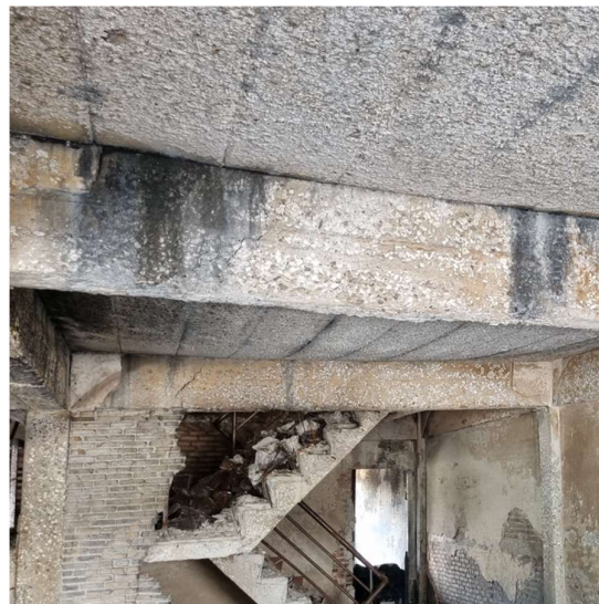
รูปที่ 1 สภาพโครงสร้างคอนกรีตเสริมเหล็กที่ถูกไฟไหม้เป็นเวลานาน
