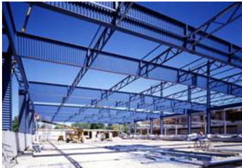
รูปที่ 1 เสาและคานหน้าตัดรูปตัวไอที่มีแผ่นเอวเป็นลอนในโครงข้อแข็ง (Corrugated web I-section portal frame) [1]
