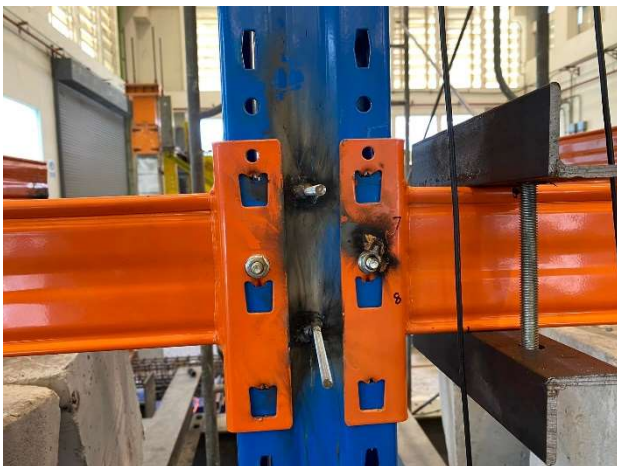
รูปที่ 9 การวิบัติเกิดขึ้นที่บริเวณข้อต่อ (Joint Connection Failure)
