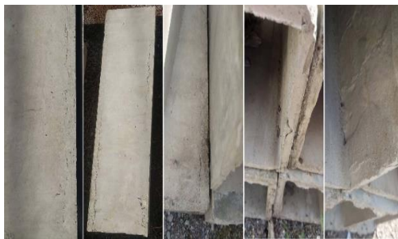
รูปที่ 16 สภาพบล็อกแบบหล่อเสา รอยร้าว ความหนาที่ไม่สม่ำเสมอ
