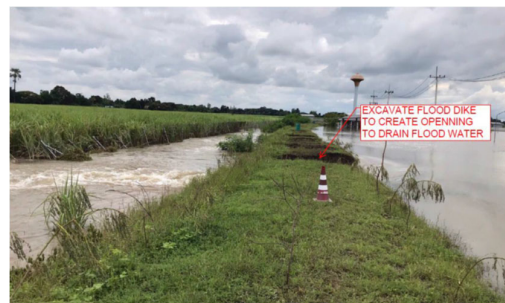
รูปที่ 3 การขุดคันดินเพื่อระบายน้ำออกจากพื้นที่
