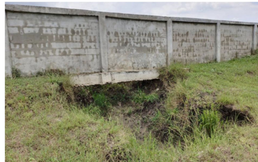
รูปที่ 4 การกัดเซาะของน้ำบริเวณกำแพงบล็อกคอนกรีตหลังน้ำท่วม
