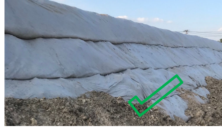
(ข) Geotextile ที่ตั้ง ดินจะไม่สามารถไหลเข้ามาได้
