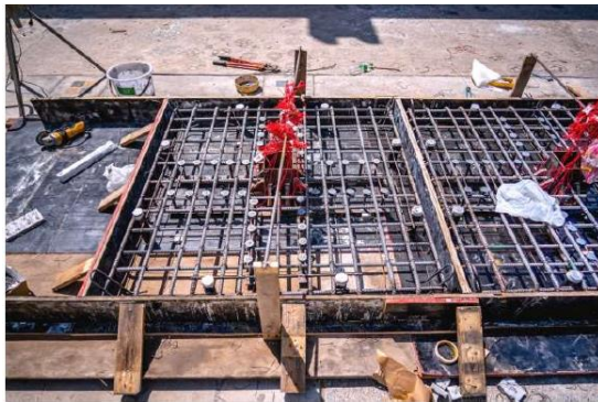
รูปที่ 5 การผูกเหล็กและติดตั้งชุดหมุดเหล็กกับแรงเฉือนในตัวอย่างทดสอบ
