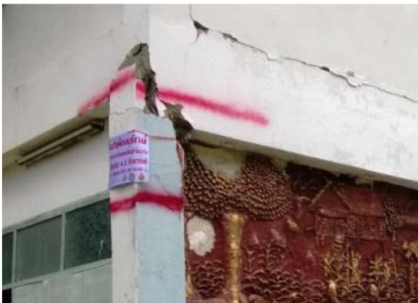
รูปที่ 1 ความเสียหายบริเวณจุดต่อคาน-เสา ของอาคารโรงเรียนแม่ลาววิทยาคม จากเหตุแผ่นดินไหวจังหวัดเชียงราย ปี พ.ศ.2557
