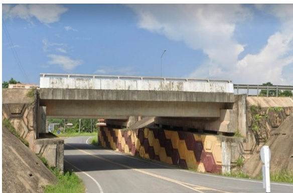
รูปที่ 12 กำแพงดินเสริมกำลัง (MSE Wall) (ที่มา : ภาพจาก Google earth ทางหลวงหมายเลข 418)
