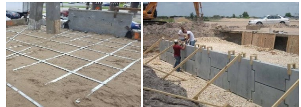
รูปที่ 20 การก่อสร้างกำแพงดินเสริมกำลัง (MSE Wall) (ที่มา : เอกสารอ้างอิง [7] NCHRP Report 663, 2016)
