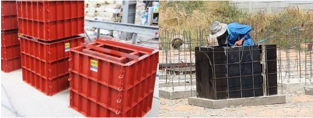
ข. การเตรียมแบบเหล็ก และการเข้าแบบกับเหล็กเสริมที่เตรียมไว้
