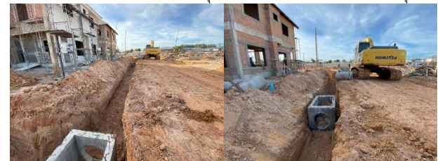
ข. ขุดร่องที่มีความลาดชัน 1:200 และวางบ่อพักห่างกัน 10 ม.(ตามแบบ)
