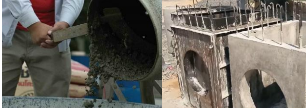
ค. การเตรียมคอนกรีตสดเพื่อเท และการเทคอนกรีตเข้าแบบ
