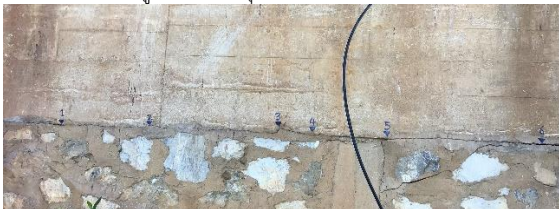
รูปที่ 7 การแตกร้าวบริเวณเสาดม่อ
