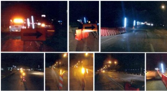
รูปที่ 7 ลักษณะการติดตั้งระบบควบคุมการจราจร
