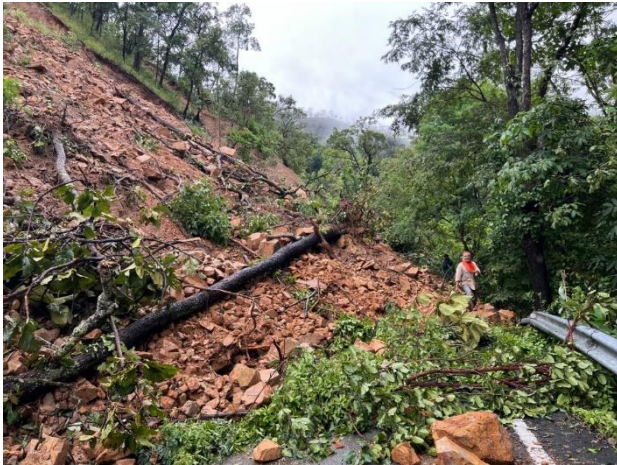
รูปที่ 1 สภาพความเสียหายบริเวณแนวเชิงลาดถนนเดิม
