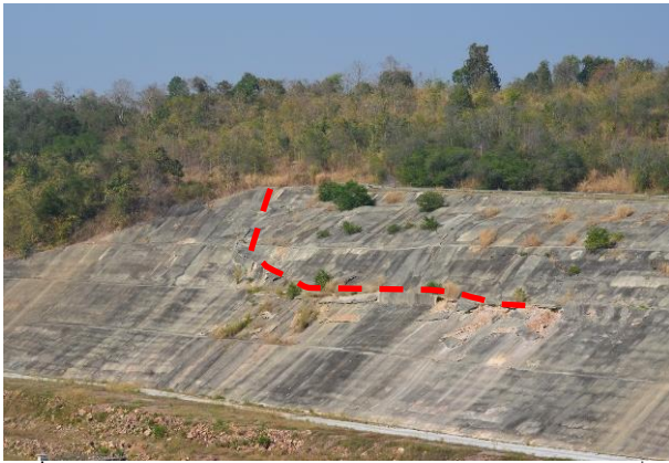
รูปที่ 2 ลักษณะสภาพการพังทลายของงานป้องกันทางลาดไหล่บริเวณท้ายเขื่อน แควน้อยบำรุงแดน (เส้นประสีแดงแสดงแนวการพังทลาย)
