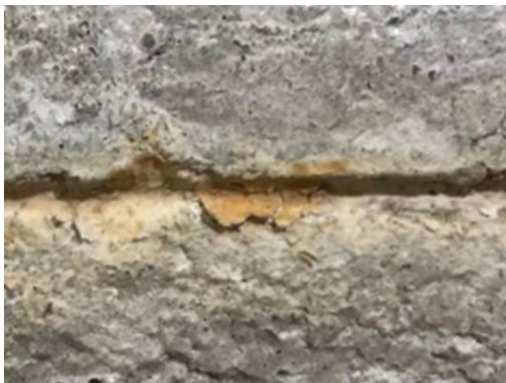
รูปที่ 5 ตัวอย่างมอร์ตาร์หลังซ่อมแซมรอยร้าว 28 วัน
