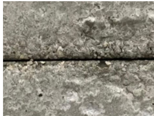
รูปที่ 6 ตัวอย่างมอร์ตาร์ที่ไม่ผ่านการซ่อมแซมรอยร้าว
