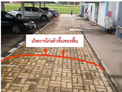
รูปที่ 2 การยกตัวของอิฐปูทางเท้ารอบอาคาร (ถ่ายเมื่อ พ.ศ.2559)
