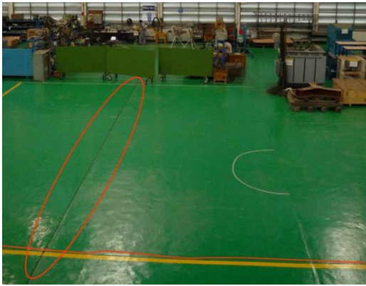
รูปที่ 1 รอยแยกของแผ่นพื้นคอนกรีตภายในอาคาร (ถ่ายเมื่อ พ.ศ.2559)
