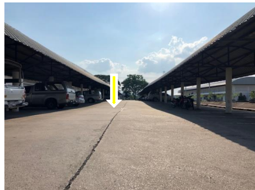
รูปที่ 5 ลักษณะผิวถนนคอนกรีตที่มีการนูนขึ้นมา (ถ่ายเมื่อ พ.ศ.2563)
