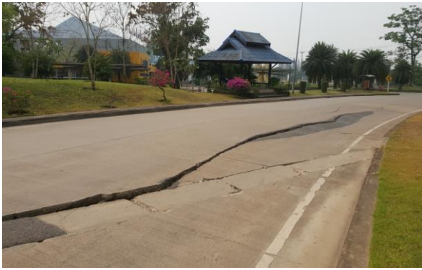
รูปที่ 1 ความเสียหายของถนนบริเวณศูนย์บริการของโรงไฟฟ้าแม่เมาะ
