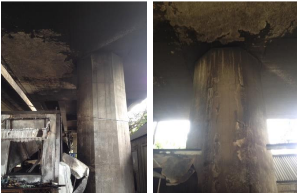
รูปที่ 2 สภาพความเสียหายของเสาตอม่อและพื้นยื่นหัวเสา จากเหตุเพลิงไหม้ได้ทางพิเศษเฉลิมมหานคร กม. 27+338
