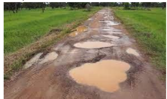
รูปที่ 2 หลุมบ่อบนถนนลูกรัง (Pothole)
