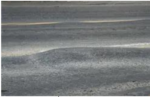
รูปที่ 4 ร่องล้อ (Rutting)
