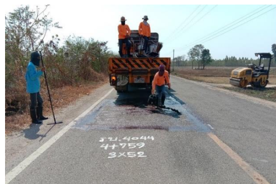
รูปที่ 15 การปะซ่อมผิวทาง (Skin Patching) กรณีความเสียหายเกิดขึ้นเป็นจุด
