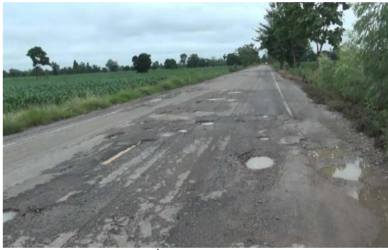
รูปที่ 19 สภาพถนนแฉ่
