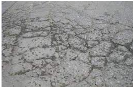
รูปที่ 5 รอยแตกร้าวแบบหนังจระเข้ (Alligator Crack)
