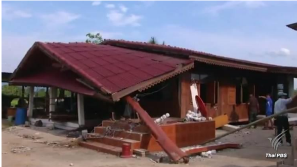
รูปที่ 8 บ้านเรือนราษฎรหลังหนึ่งในบ้านท่ามะโอที่เสาหักพังลงกับพื้นดิน [9]
